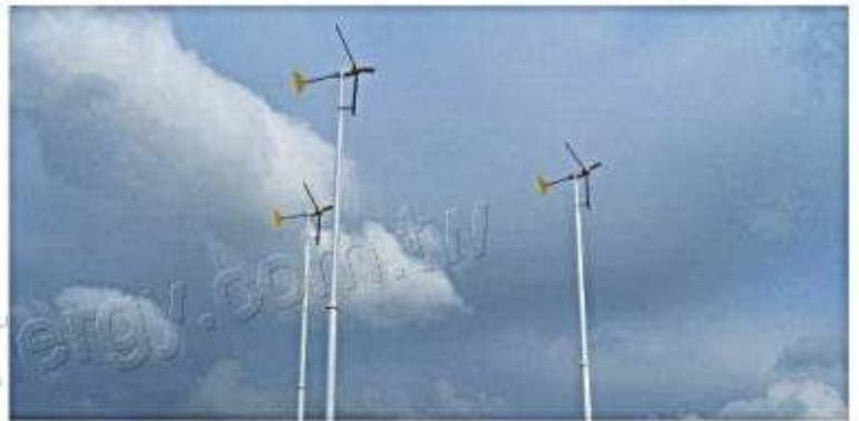
中華大學5kW獨立供電系統(上) 新竹體育場1kW三台併聯供電(下)
