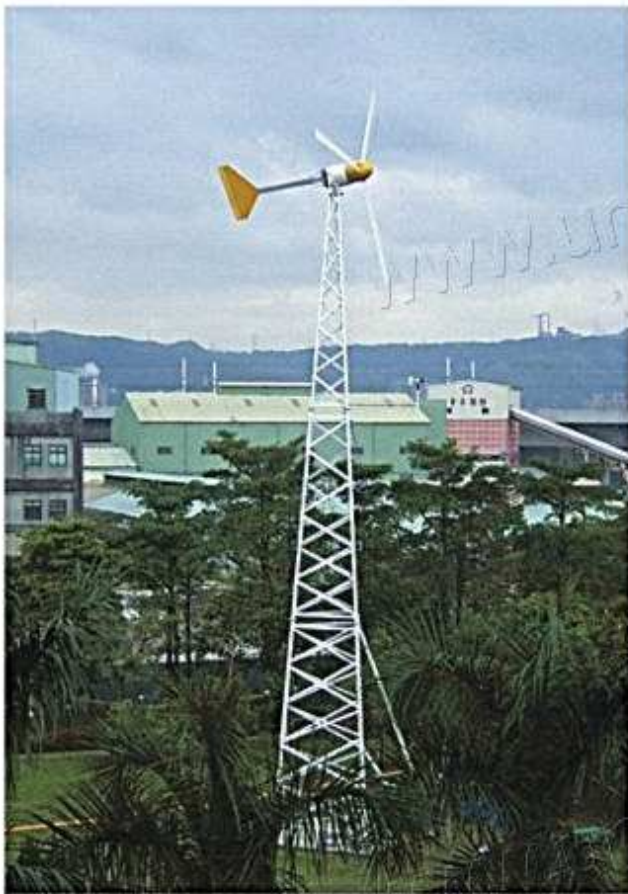
台電綜合研究所10kW風力發電市電併聯系統
